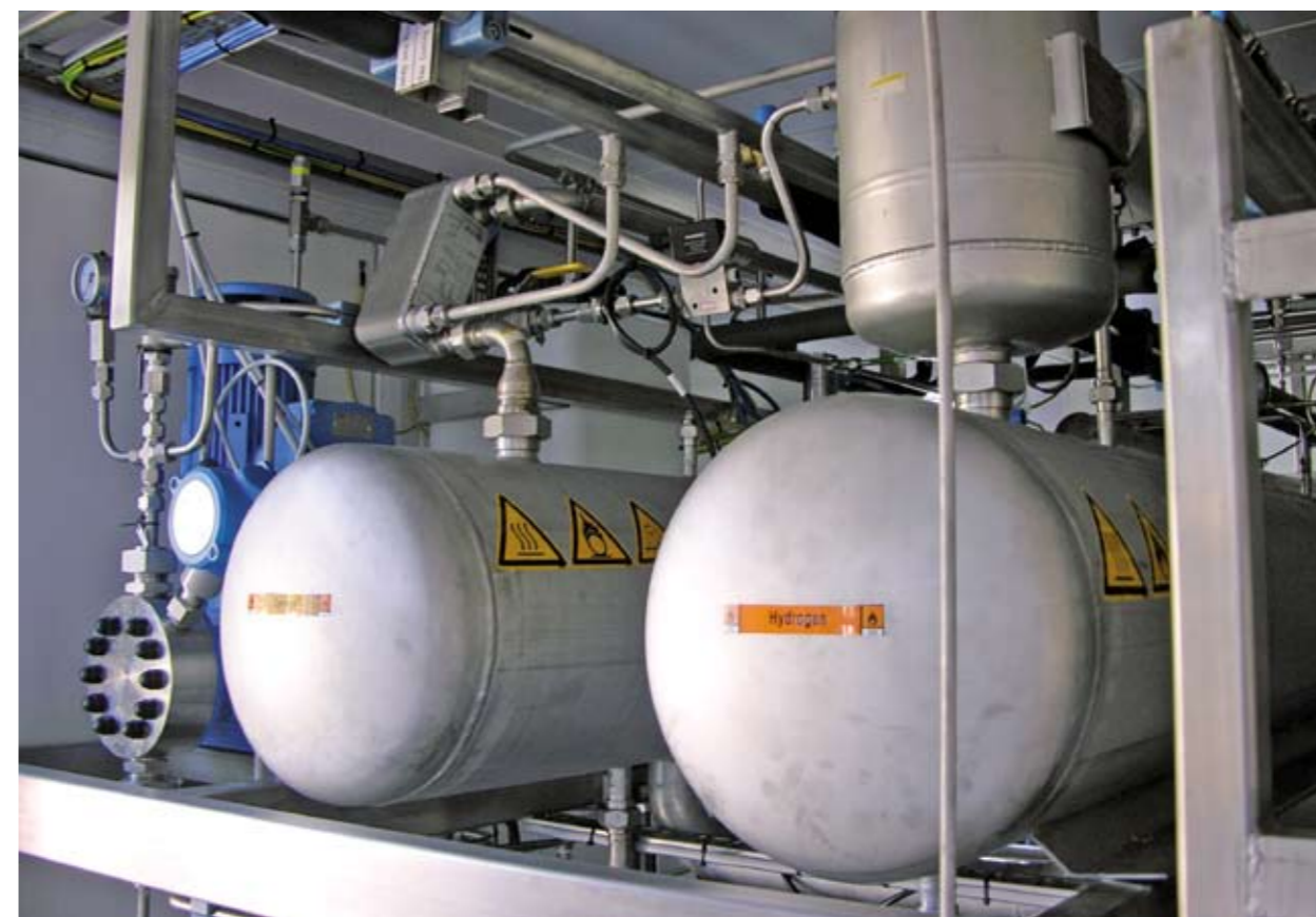
DETALHE DA UNIDADE DE PRODUÇÃO E ABASTECIMENTO DE HIDROGÊNIO PARA O ÔNIBUS BRASILEIRO Fonte: Carlos Zundt - 2008.
